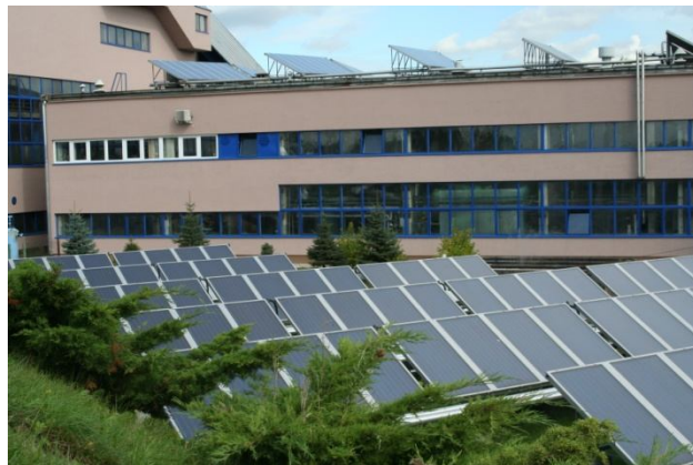
Solaranlage in Wołomin; Quelle: ZEC in Wołomin Sp.z.o.o.
